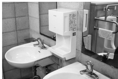
設置された温風乾燥機
