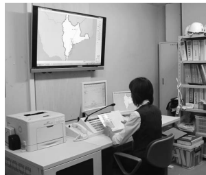
防災無線（通信室）
